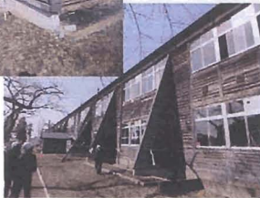
木造校舎の被害(古川第1 小学校)
