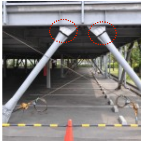
Fractura de las placas de apoyo de ambos extremos en la dirección EW
