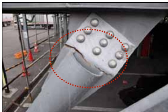
Fractura tipo de la placa de apoyo de varias diagonales
